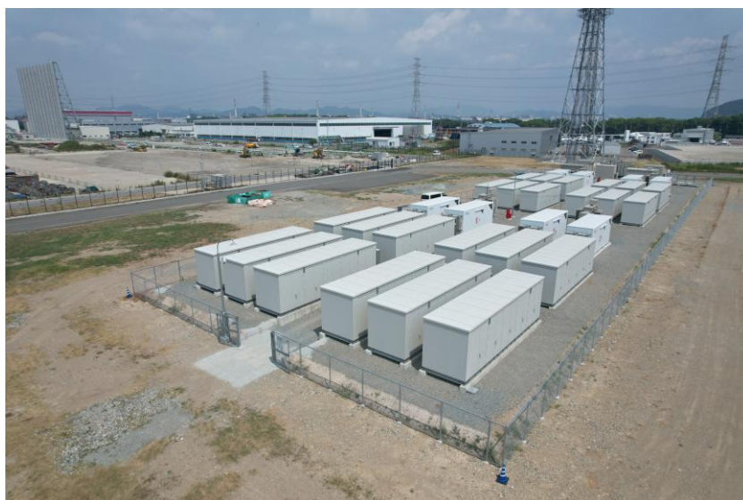
(姫路蓄電所／2025年8月撮影)
